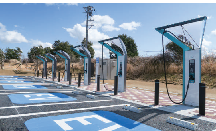
浜松SAには、最大150kWの新型急速充電器を設置。さらにマルチプラグ器（最大90kW）6口器も併設。
